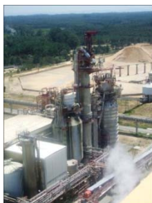
Figura 102 – Digestor de polpação química
