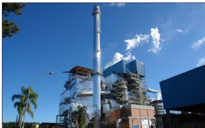
Figura 108 – Caldeira de recuperação.
